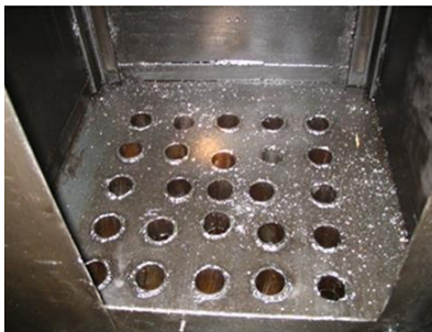
Figur 15 Inloppen för oljeflöde till hisschakt i pusherugn.
