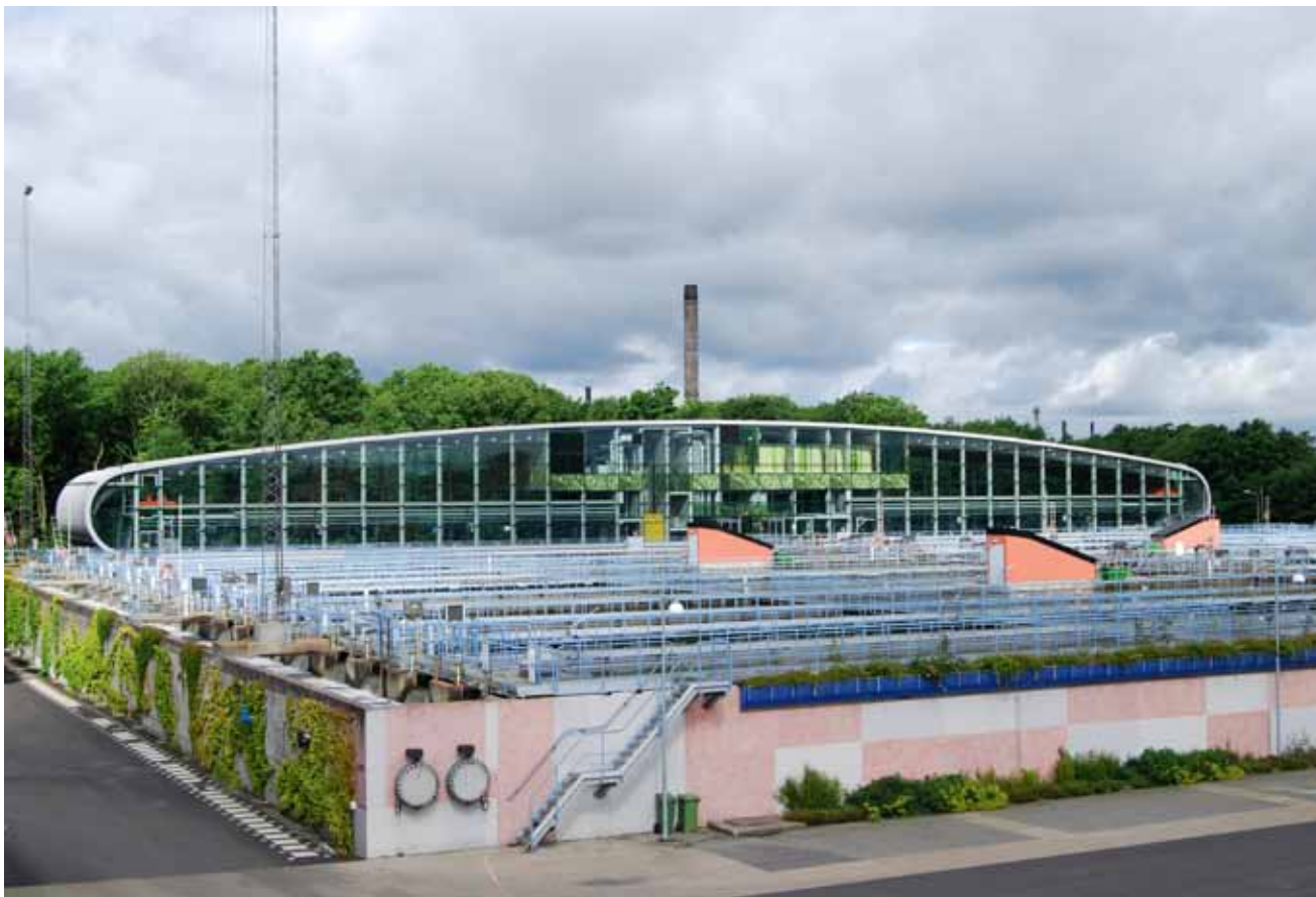
Skivfilteranläggningen på Ryaverket i Göteborg, med bassänger i förgrunden.
