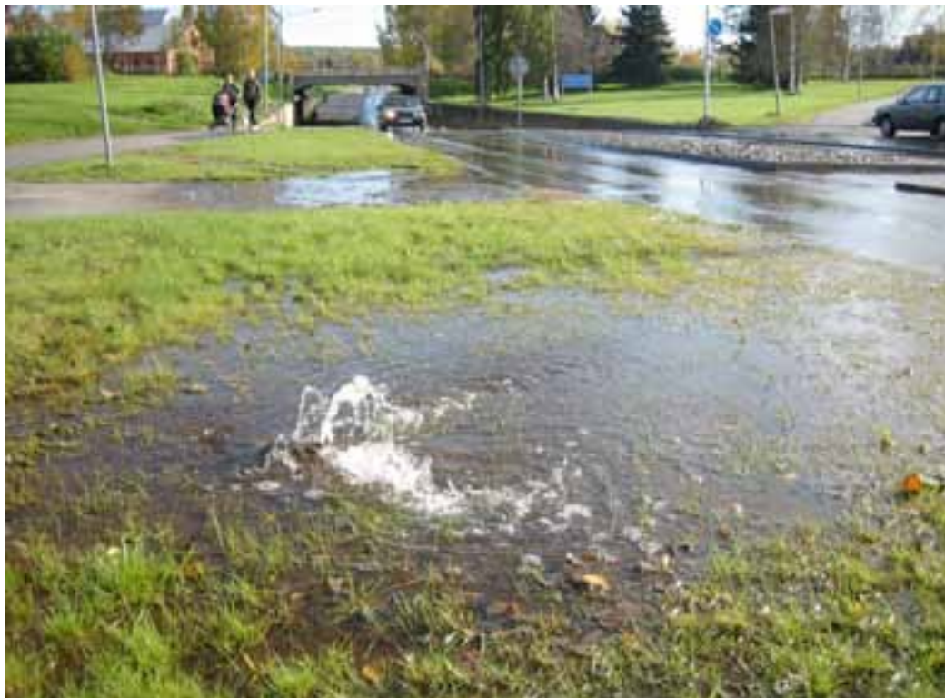
Underdimensionerat dagvattensystem vid snösmältning.
