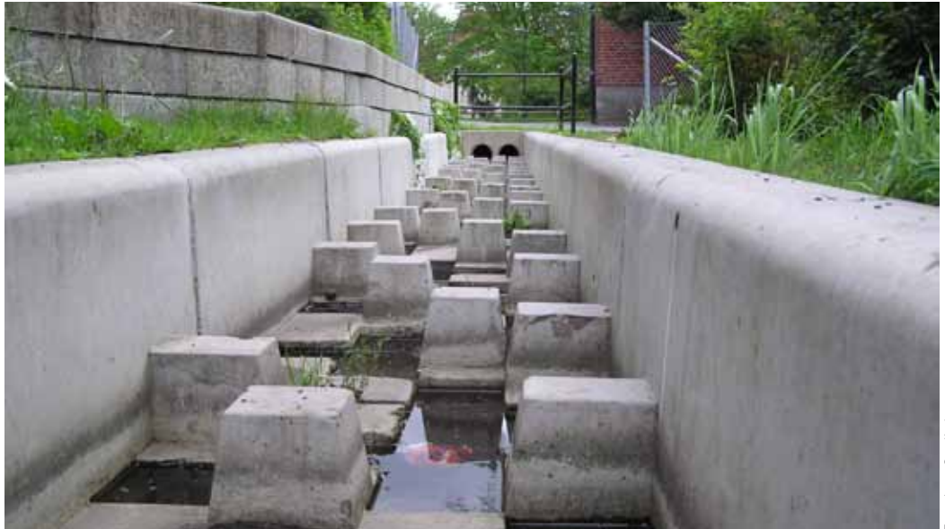
En kubkanal för dagvatten i Augustenborg i Malmö.
